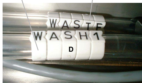
Abb. 5-7 Anschlüsse des Waschblocks
