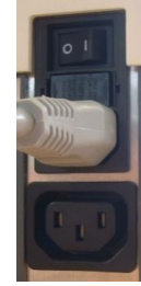
Ana elektrik fişi
